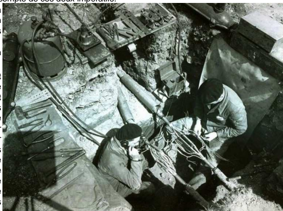
Raccordement sur câble coaxial et câble à quartes
