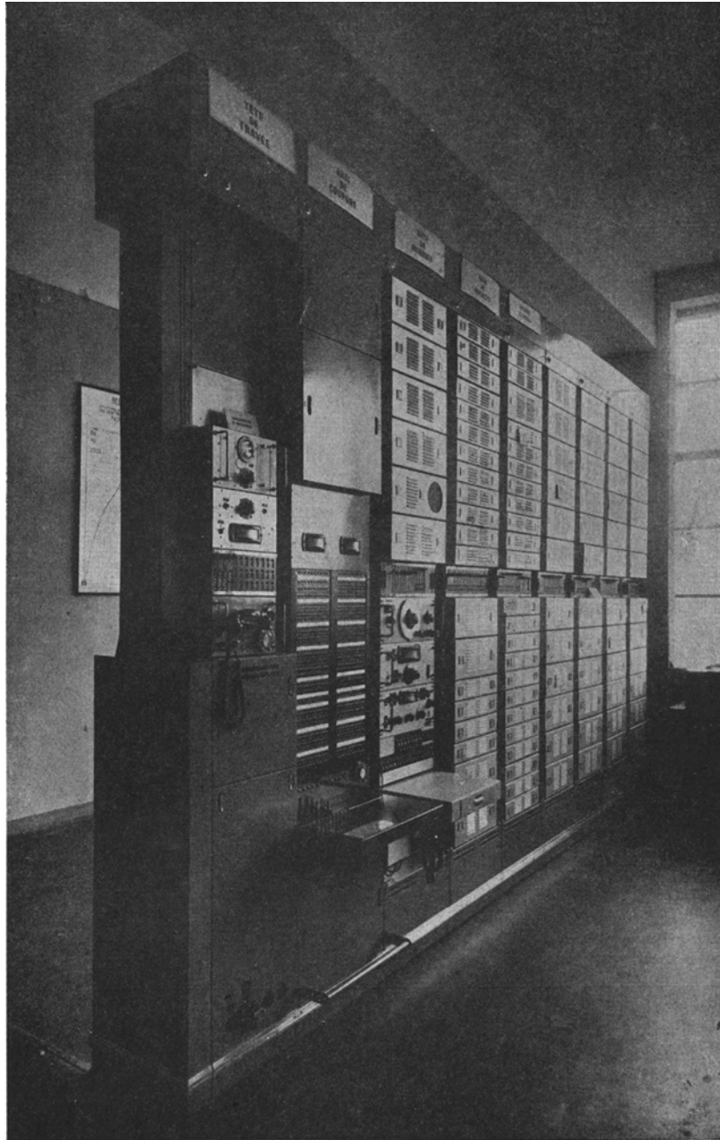
FIG. 2. — Travée de démonstration en matériel L. T. T., type 1944, installée à Paris-Saint-Amand et comprenant de gauche à droite : un bâti d'alimentation, un bâti de coupure, un bâti de mesures, un bâti de sources 12 voies, un bâti d'organes 12 voies et 4 bâtis d'organes standards. Les bâtis 12 voies sont presque uniquement pourvus de demi-platines.
